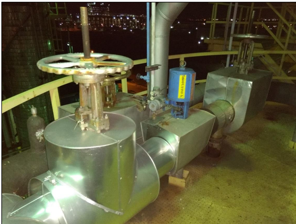
Figura 20: Válvula 5100-LV-004 (cortesia Petrobras)
