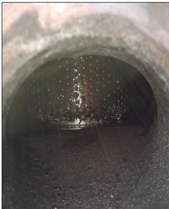
Figura 21: Desgaste no Interior da Válvula Globo Gaiola (cortesia Petrobras)
